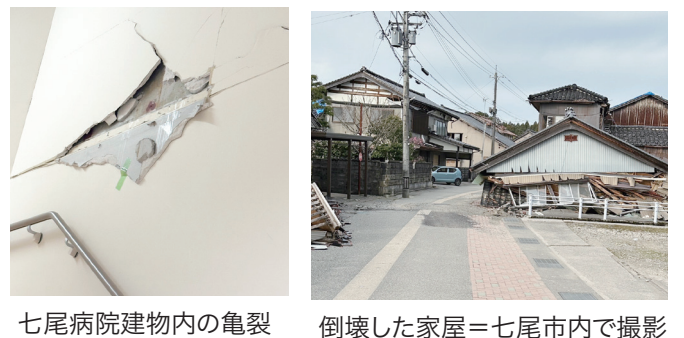
七尾病院建物内の亀裂 倒壊した家屋=七尾市内で撮影
